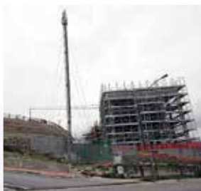
TRALICCIO L'antennone per la telefonia mobile che giganteggia su via Ligure, a Potenza. I residenti temono che la vicinanza dell'impianto possa essere nocivo alla salute [foto Tony Vecce]
