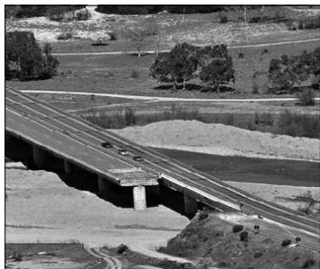
Il viadotto Calciano 2 crollato nel 2011 e la sponda del fiume Basento visibilmente erosa
