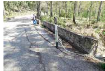
FESSURAZIONI Sono frequenti lungo il percorso stradale
