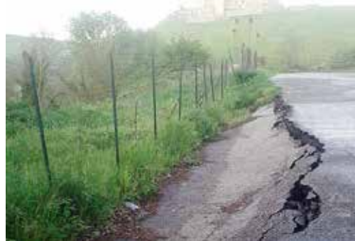
DISSESTO La frana che interessa via Dante Alighieri a Valleverde di Melfi (foto m.t.)
