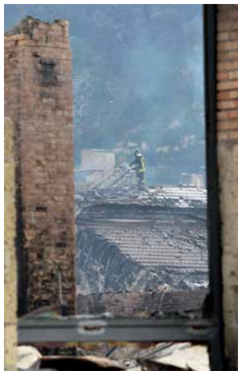
Un particolare della struttura distrutta FOTO L'ESPRESSO
