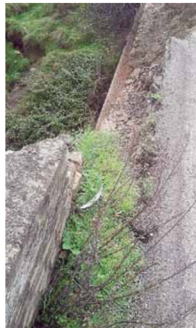
CEDIMENTO il ponte crollato sulla strada per Pisticci, ex statale 176
