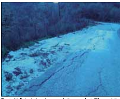
Due tratti di strada franata e accanto il personale dell'Anas e della Protezione civile che ha bloccato il traffico
